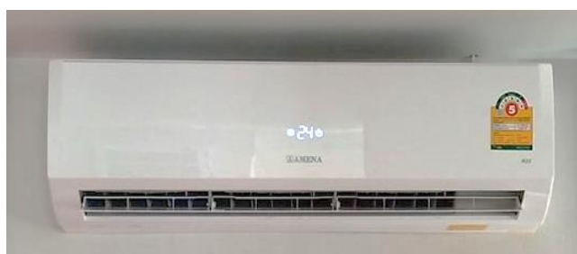
ภาพที่ 3.5 คอยล์เย็น เครื่องปรับอากาศ ขนาด 20,397 BTU.
