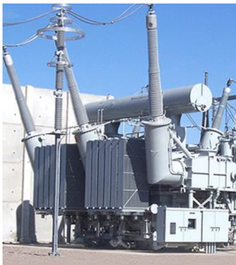
ภาพที่ 2.11 หม้อแปลงกำลัง
