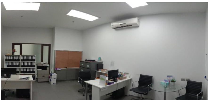
ภาพที่ 4.5 เครื่องปรับอากาศห้องทำงานนิติบุคคลฯ
